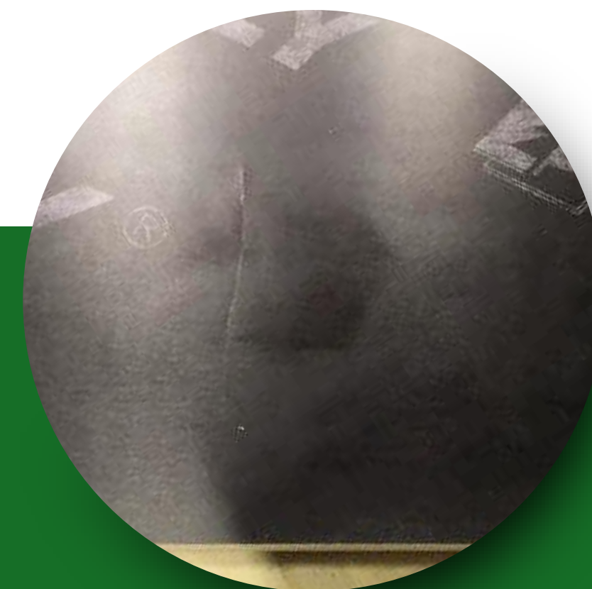
Вздутие с повреждением покрытия
