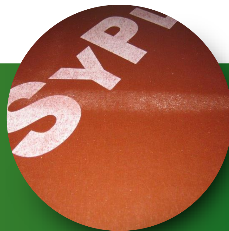
Прогар без признаков разрушения пленки
